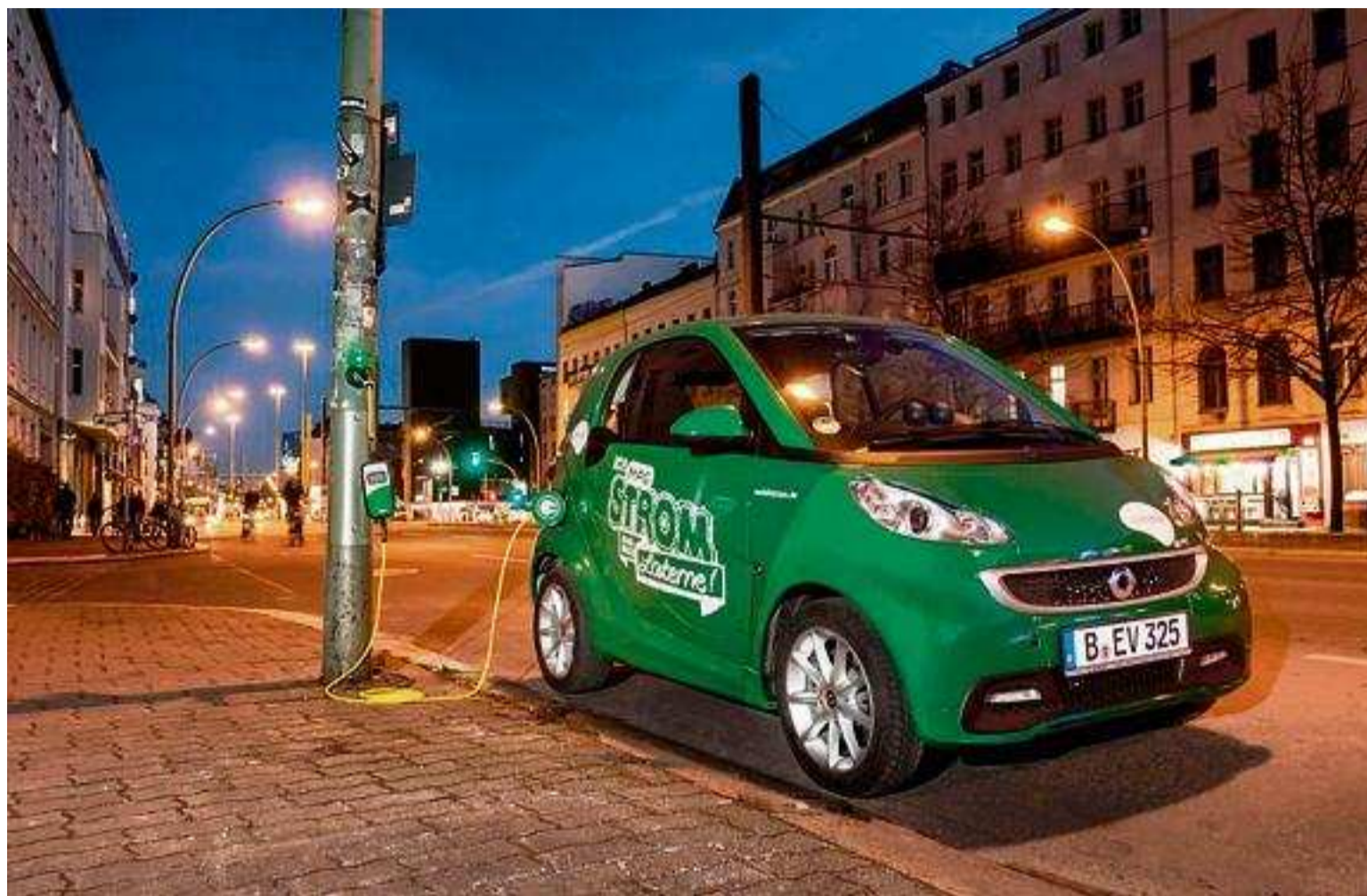
La solution de l'entreprise berlinoise permet d'installer des prises sur les mâts d'éclairage public. Ici, en Allemagne, en 2017. UBITRICITY
