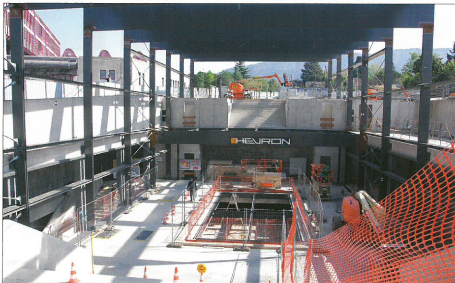
Installations en surface de la nouvelle gare de Carouge Bachet (23 septembre 2017).
